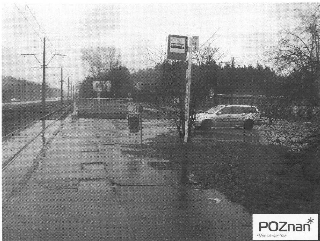
Fot. Uszkodzona nawierzchnia platformy przystankowej stwarza bezpośrednie zagrożenie wysiadającym pasażerom
