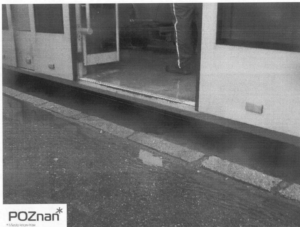
Fot. Niska platforma uniemożliwia samodzielny wjazd osobie poruszającej się na wózku
