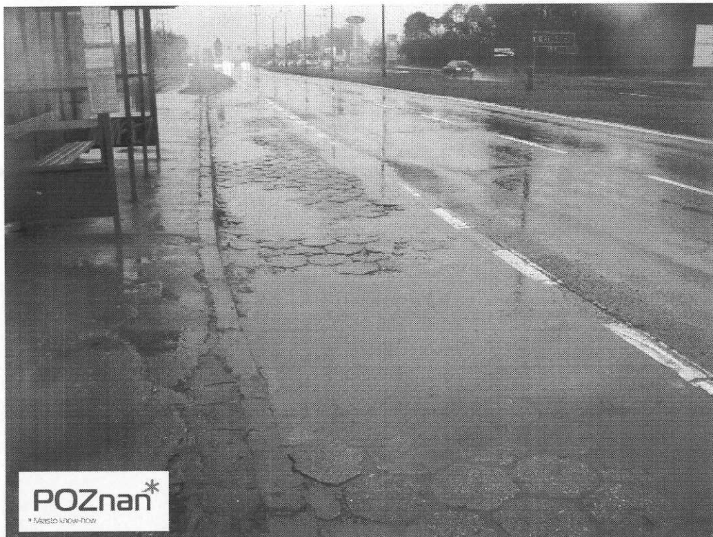
Fot. Zły stan zatoki przystankowej całkowicie uniemożliwia korzystanie z niej w czasie deszczu
