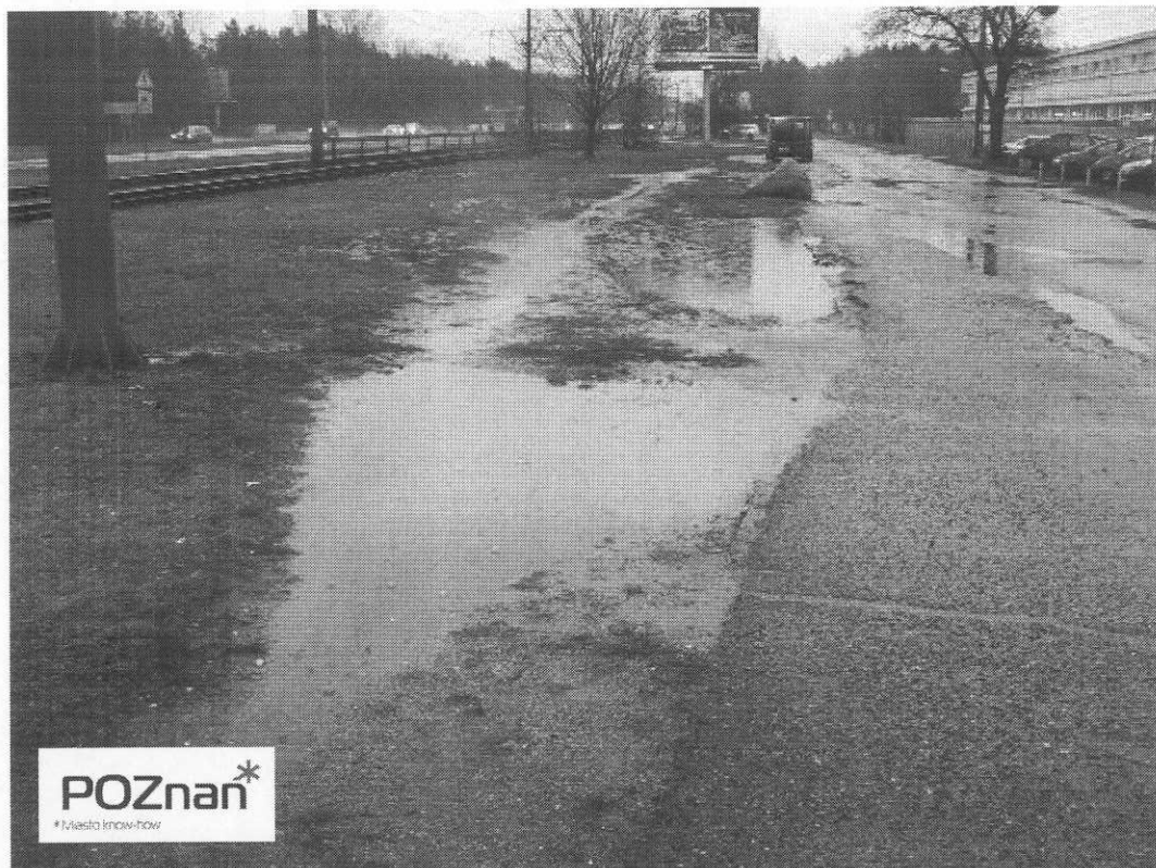
Fot. Brak chodnika od strony zajezdni MPK
