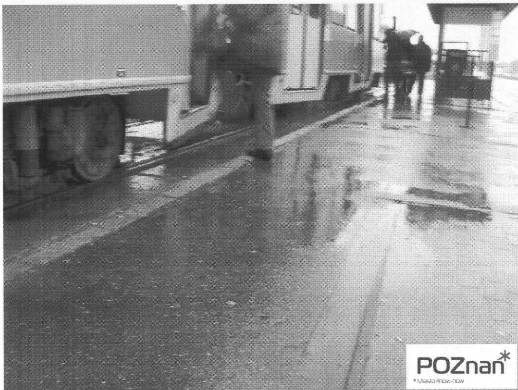
Fot. Źle wytyczona linia zatrzymania. Bliskość wiaty jest poważnym zagrożeniem dla pasażerów. Tu także widać zbyt niski poziom platformy przystankowej
