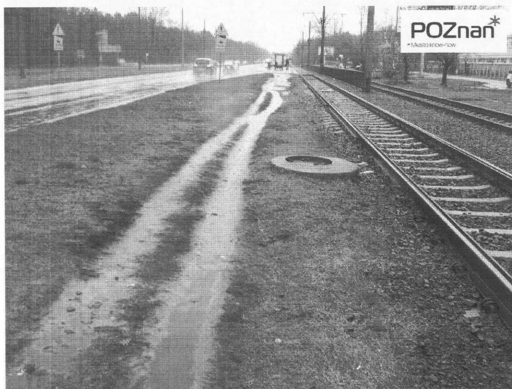
Fot. Brak chodnika od strony ul. Warszawskiej
