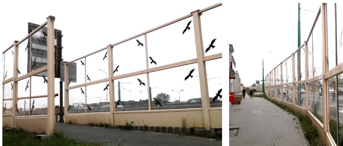
Rys. 46. Przejrzyste ekrany przeciwhałasowe odbijające (na zakładkę) w pobliżu zabudowy mieszkaniowej przy ul. Głogowskiej w Poznaniu
