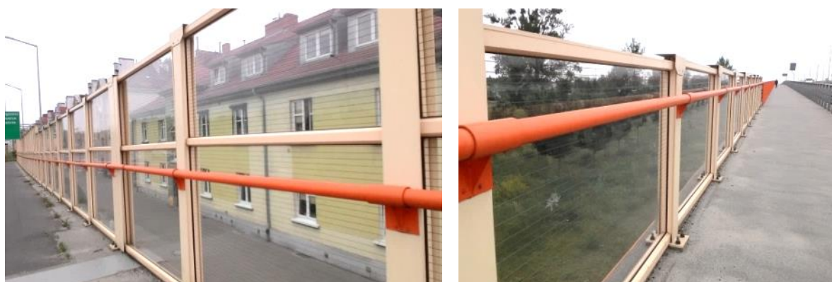
Rys. 47. Przejrzysty ekran przeciwhałasowy odbijający o lekkiej konstrukcji na wiadukcie Kosynierów Górczyńskich w Poznaniu
