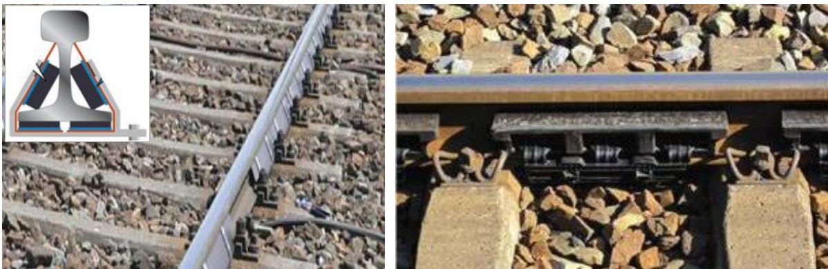
Rys. 40 Absorbery wibroizolacyjne (DB Netze: Innovative Maßnahmen zum Lärm- und Erschütterungsschutz am Fahrweg, Schlussbericht, 15.06 2012)
