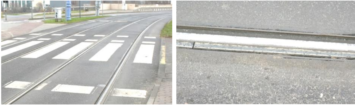
Rys. 41 Torowisko w jezdni z systemem tłumiącym ORTEC na ul. Mostowej w Poznaniu
