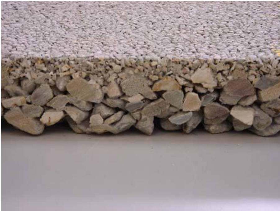
Rys. 23. Budowa nawierzchni dwuwarstwowej (Evaluation of U.S. and European Concrete Pavement Noise Reduction Methods, National Concrete Pavement Technology Center, 2006)
