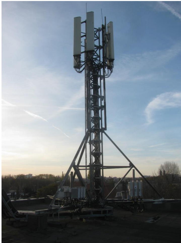
Zał. nr 1: Widok ogólny instalacji radiokomunikacyjnej.
